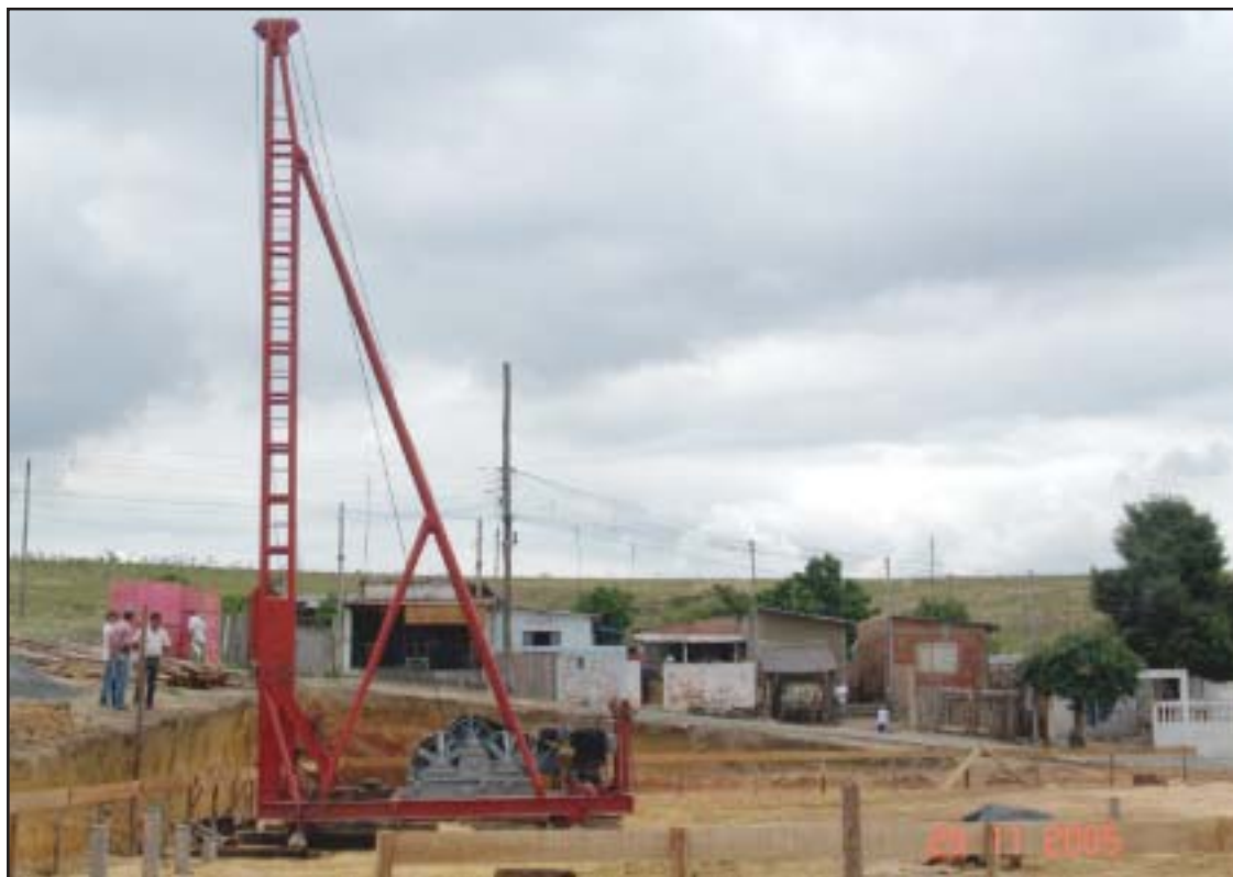
Obras de fundação na área onde se localizará a escola nova do Jardim América
