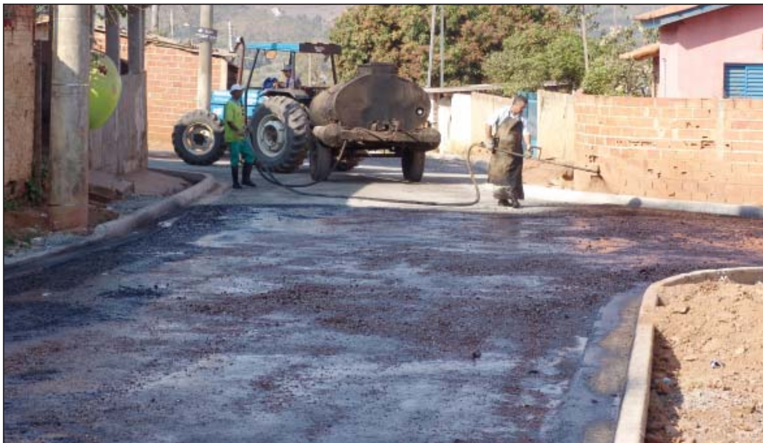
Depois das guias e sarjetas, as ruas do bairro Piraporinha já estão recebendo pavimentação asfáltica
