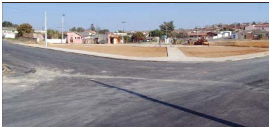
Prosseguem em ritmo acelerado as obras nos jardins Paulistano e das Bandeiras
